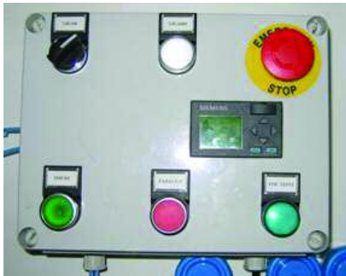
Figura 2 - Central de comando
